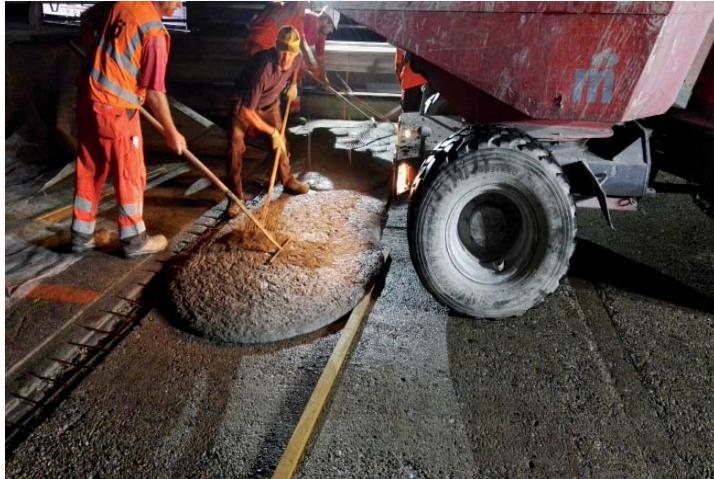
Pose du BFUP sur le tablier réalisée les week-ends avec fermeture complète du viaduc
