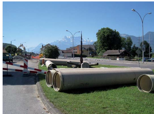
Conduites de gros diamètre
